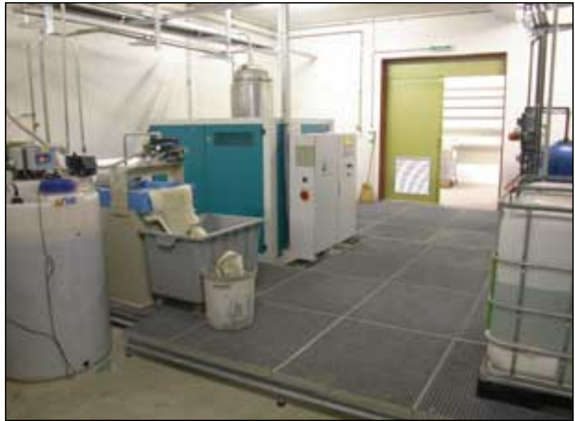
Abb 8) Verdampfer in der Abwasseraufbereitungsanlage
